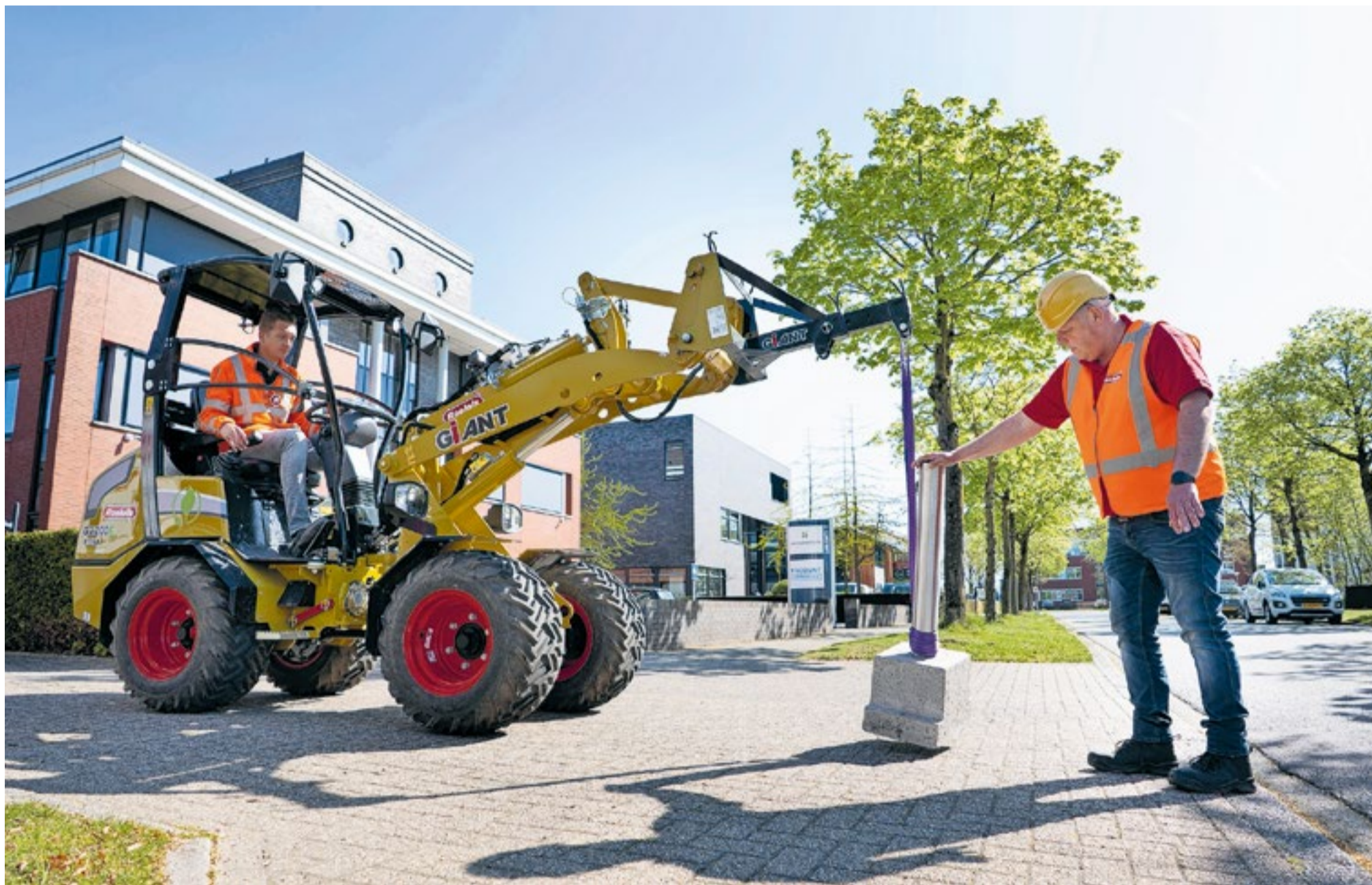
Bouwbedrijf Roelofs heeft sinds een jaar een elektrische shovel in gebruik die het werk van bouwvakkers helpt verlichten.
